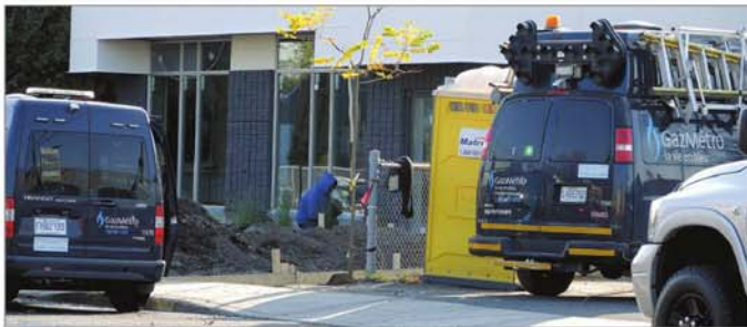
Une excavatrice a accroché une conduite de Gaz Métro. PHOTO TC MEDIA - MARTINE VEILLETTE
