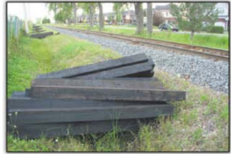
La voie ferrée qui traverse le territoire est tachetée de peinture orange, signe que des réparations sont nécessaires à ces endroits, comme ici à Varennes, à l'intersection du boulevard de la Marine et de la route Marie-Victorin.
