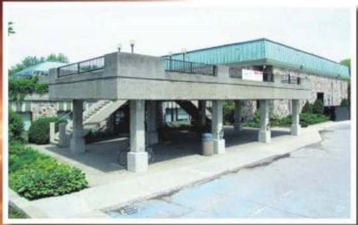
Le centre sportif Pierre-Laporte a subi quelques infiltrations d'eau.
